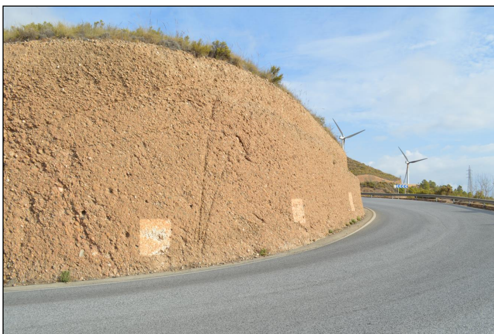
Fotografía 3. Terciario conglomerático en el talud de la carretera existente
