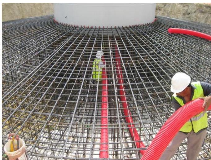
Figura 8. Canalización para extraer los cables de potencia y comunicaciones del interior de la torre por dentro de la cimentación.
