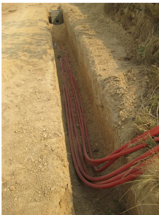
Figura 10. Conductores de potencia ubicados en zanja.
