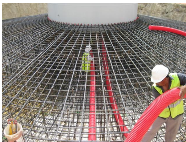
Figura 8. Canalización para extraer los cables de potencia y comunicaciones del interior de la torre por dentro de la cimentación.
