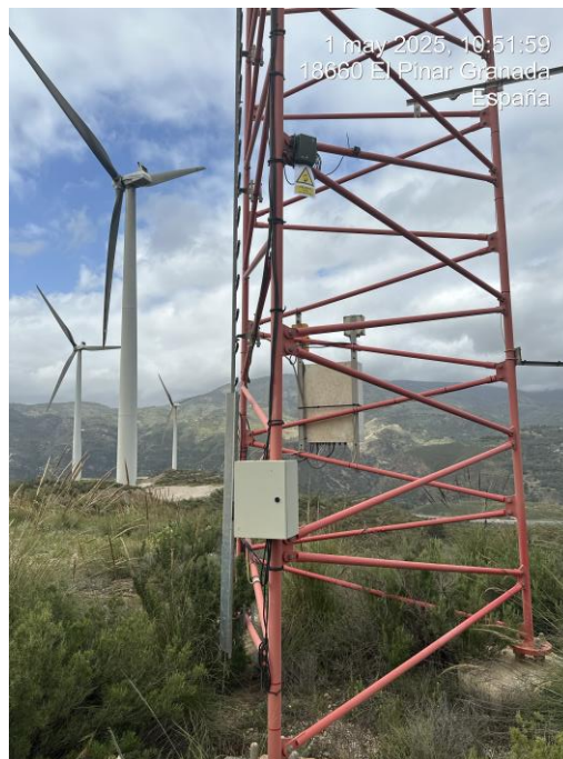
Fotografía 1. Grabadoras Torre Anemométrica
